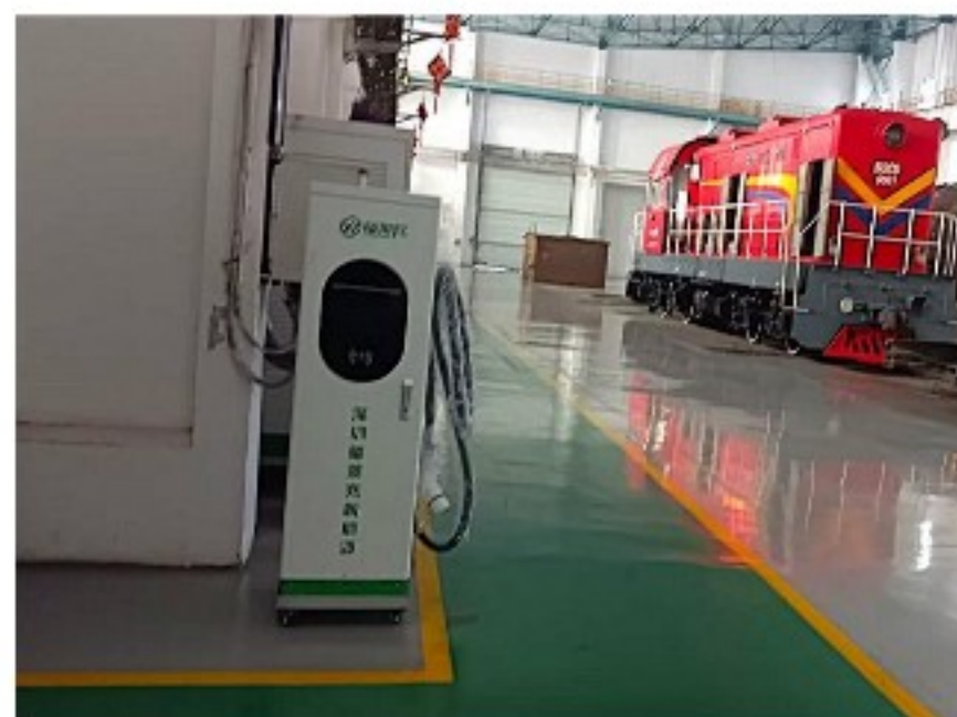
新疆八一钢铁厂火车充电项目
