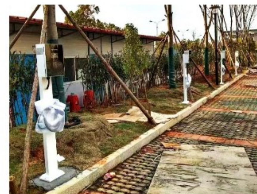
吉安城投充电桩项目
