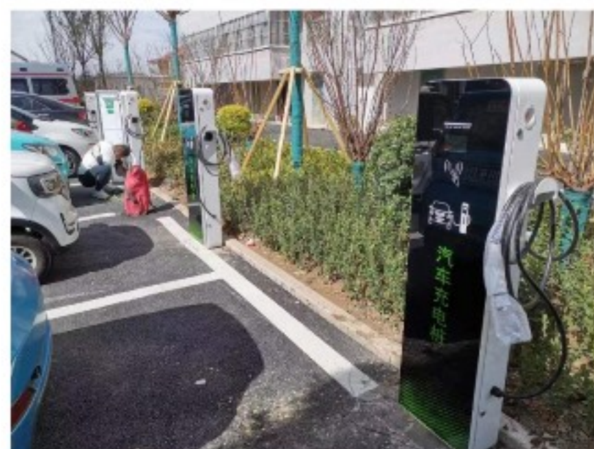
华润地产充电站项目
